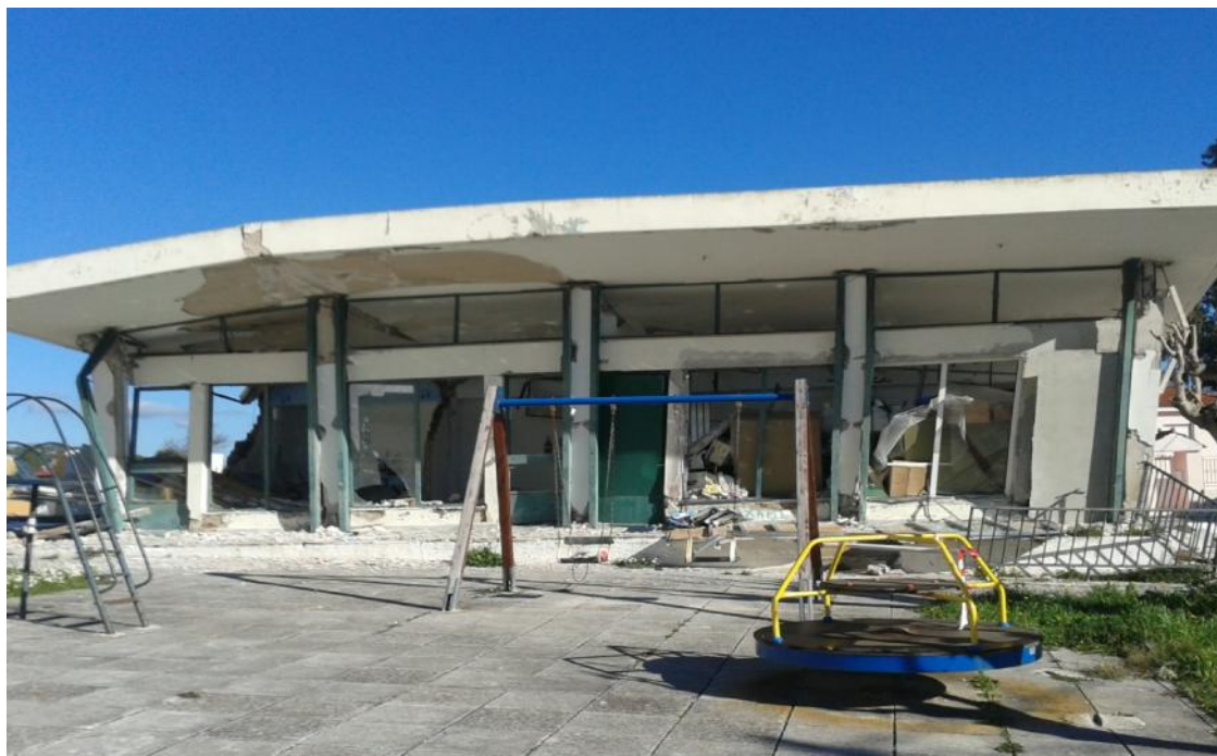
Εικόνα 17 - Μερική κατάρρευση (απώλεια ύψους) μονώροφου κτιρίου λόγω ανεπαρκούς αντισεισμικού σχεδιασμού (Φωτογραφικό υλικό Δ/σης Π.Π. Δήμου Κεφαλονιάς).
