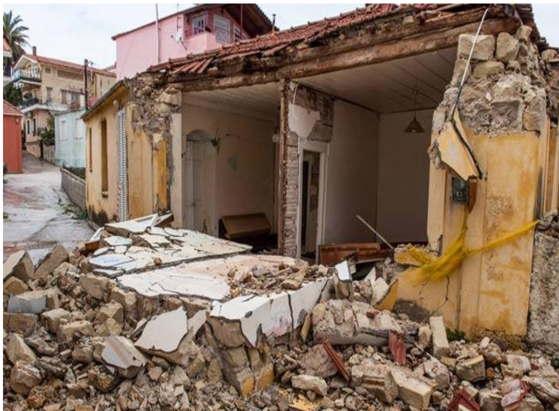
Εικόνα 19 - Κατάρρευση μονώροφου κτιρίου μεγάλης παλαιότητας κατασκευασμένου από ευτελή υλικά και με ανεπαρκή συναρμογή στέγης και λιθοδομής - απουσία διαφραγματικής λειτουργίας (Φωτογραφικό υλικό Δ/σης Π.Π. Δήμου Κεφαλονιάς).
