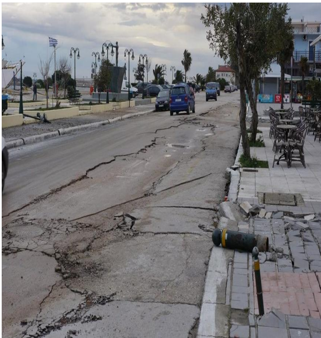
Εικόνα 13 - Βλάβες στο εσωτερικό οδικό δίκτυο του Ληξουρίου (Πηγή: Δ/ση Πολιτικής Προστασίας Δήμου Κεφαλονιάς).
