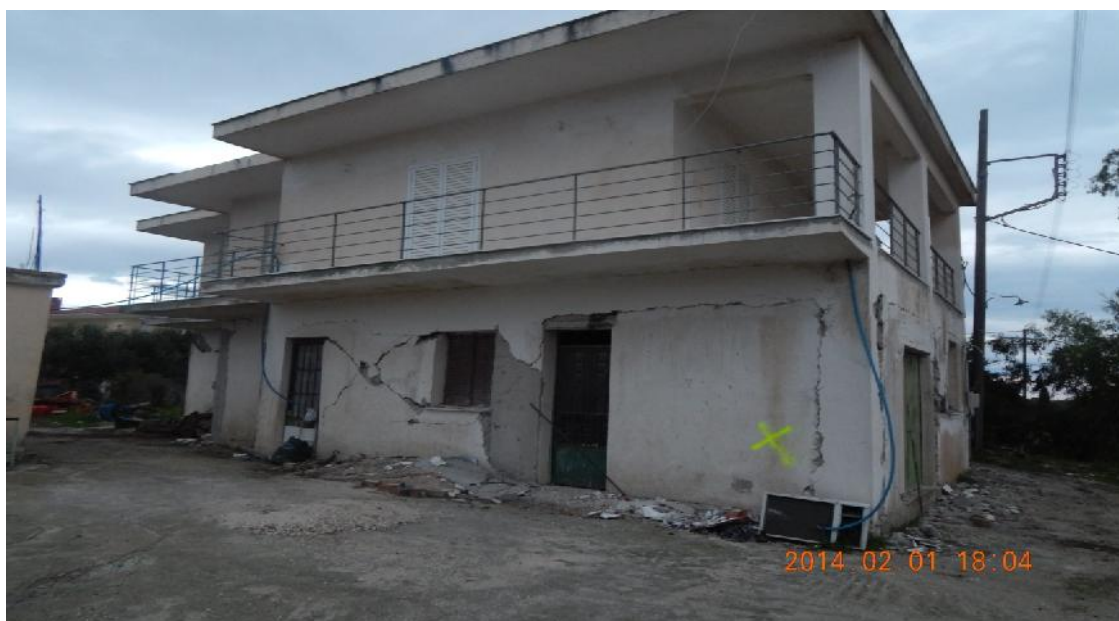
Εικόνα 18 - Διατμητικές ρωγμές στην τοιχοποιΐα ισόγειου δώροφου κτιρίου λόγω απουσίας φερόντων κατακόρυφων στοιχείων υψηλής ακαμψίας (τοιχώματα) και ενδεχομένως κατασκευαστικών ανεπαρειών (Φωτογραφικό υλικό Δ/σης Π.Π. Δήμου Κεφαλονιάς).
