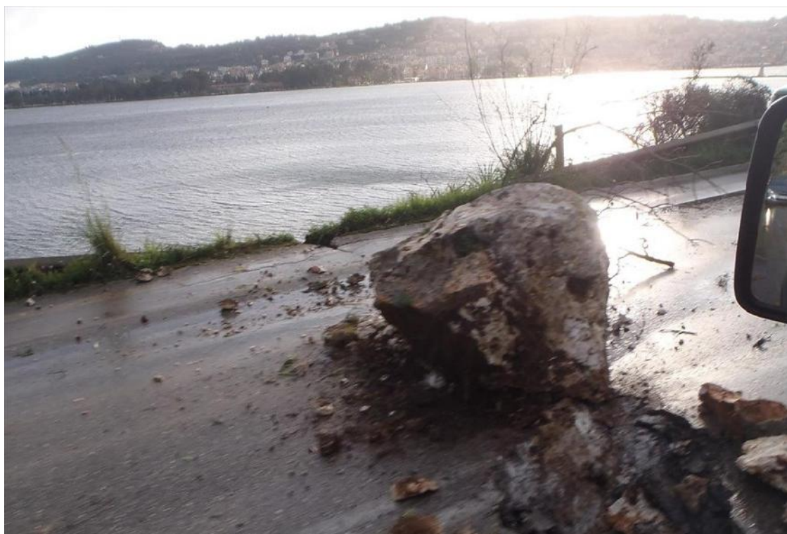
Εικόνα 20 - Κατολίσθηση μεγάλου βράχου στο επαρχιακό οδικό δίκτυο και αχρήστευση του οδοστρώματος (Φωτογραφικό υλικό Δ/σης Π.Π. Δήμου Κεφαλονιάς).
